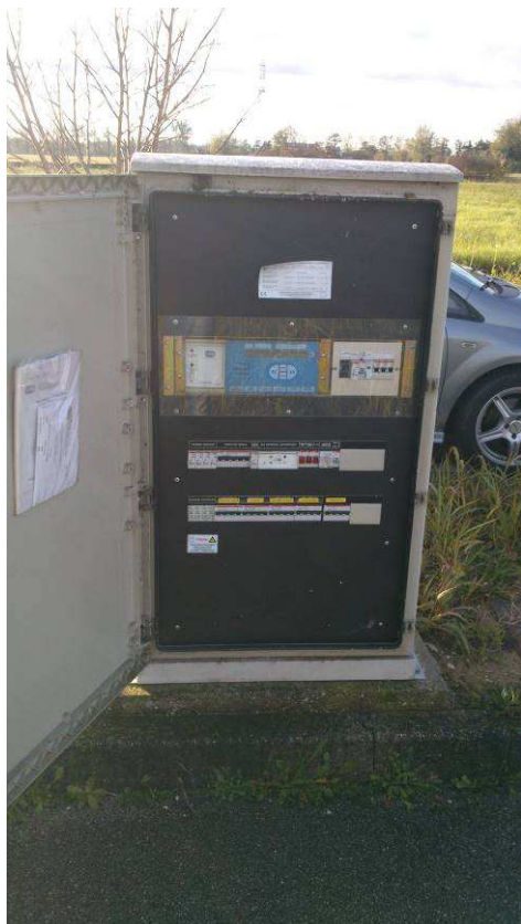
Situazione attuale Quadro Elettrico 49 – Via Antonio Zanco
