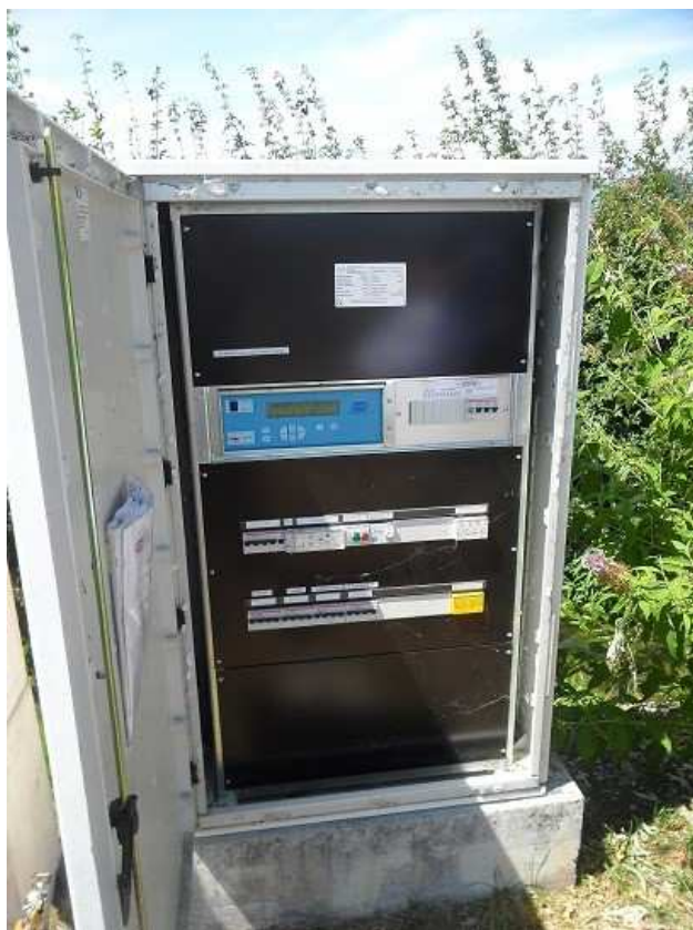
Situazione attuale Quadro Elettrico 46 – Via Martiri della Libertà
